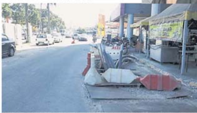
移置地下电缆工程未完成，以致锡米山大路的排水系统工程受阻。
